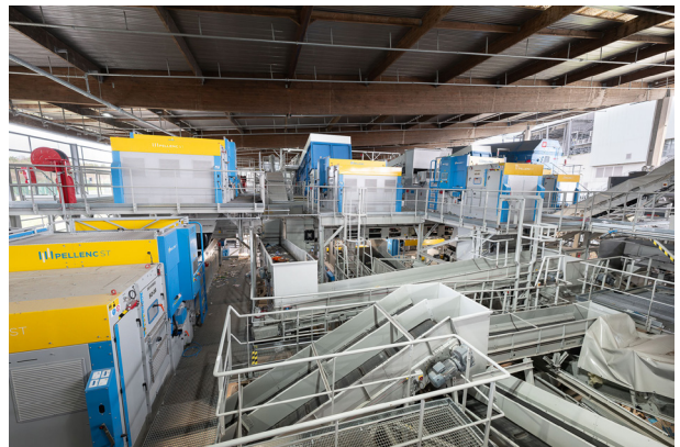
Photo 1 : Vue sur le process du Centre de tri optimisé
